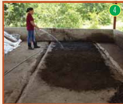
Aplicar agua para humedecer la capa de suelo. Esto debe realizarse después de colocar cada capa de material.
