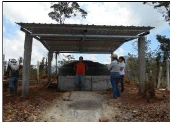
Figura 15. Tanque instalado en la comunidad de El Naranjito, El Merendón.
