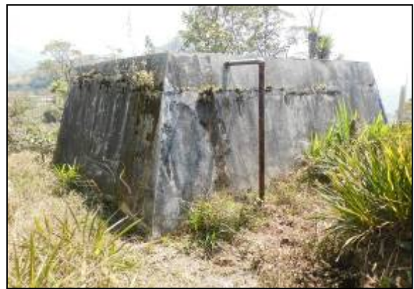
Figura 12. Tanque para almacenamiento de agua en la comunidad de El Naranjito, mostrando daños con fisuras.
