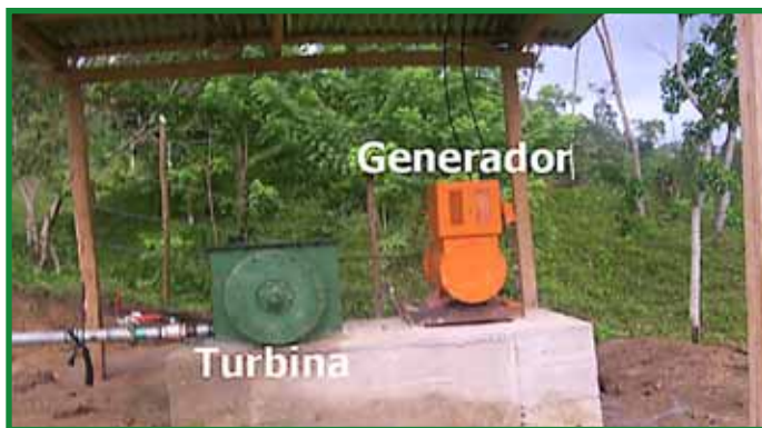
Microturbina y generador de energía eléctrica instalado en la comunidad de Las Delicias, Esparta, Atlántida.
