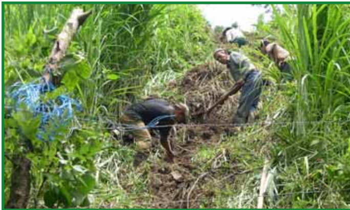
Los miembros de la comunidad participaron en la apertura de la zanja donde se instaló la tubería que conduce el agua hacia la microturbina.
