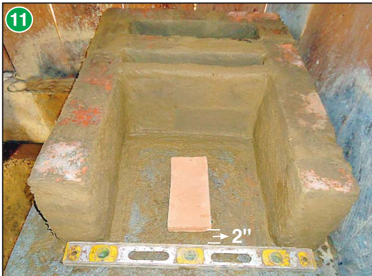
Colocar la primera pieza del codo de barro 2" hacia dentro de la parte frontal y al centro de las paredes para formar la cámara de combustión.
