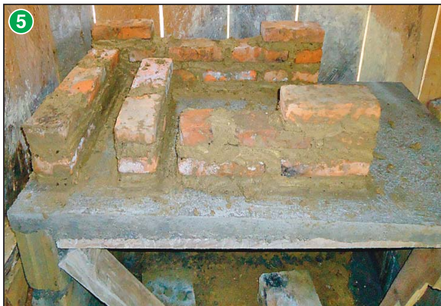
Colocar 3 ladrillos (uno en cada esquina) para iniciar la construcción de la tercera hilada.
