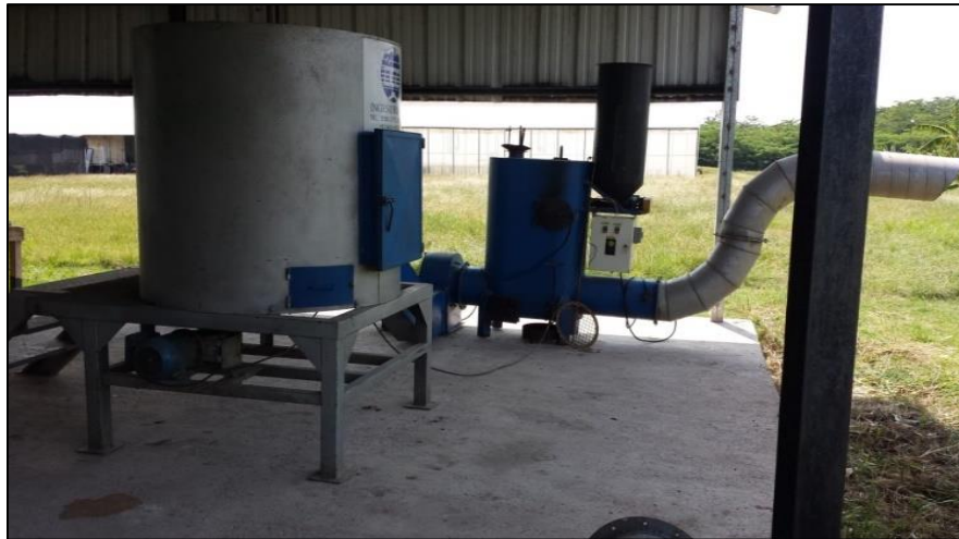
Figura 11. Secadora OGO instalada en Comayagua.
