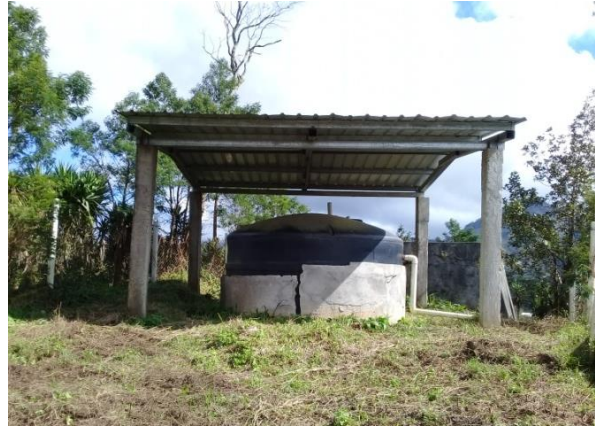
Tanque instalado en comunidad de El Naranjito.
