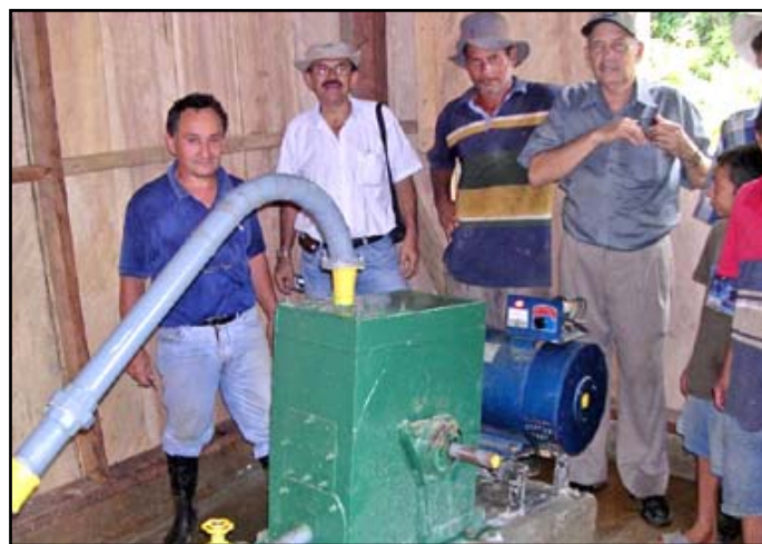
Micro hidro turbina (12.5 kW) instalada en El Recreo, La Masica, Atlántida.
