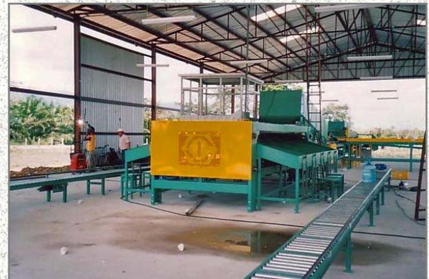
⚡ Instalación de la línea de empaque adquirida en México para procesar 10 tm/hora de naranja con calidad de exportación en Sonaguera, Colón.
